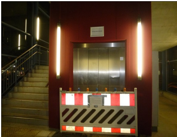
Abbildung 44: Die Aufzüge zur Brücke in Tornesch waren „ab dem 13.10.2014 aus sicherheitsrelevanten Gründen“ außer Betrieb.
