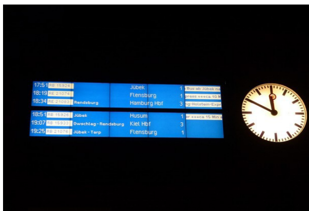
Abbildung 19: Diese Uhr an der Seite des Bahnhofsgebäudes in Schleswig war wie auch die Uhren auf den Bahnsteigen defekt.
