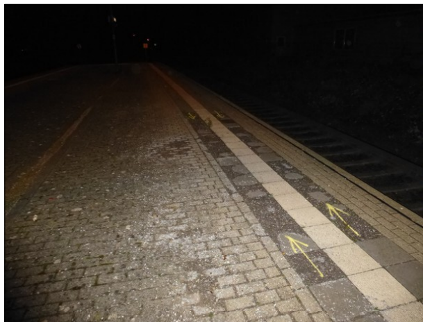
Abbildung 4: Die Schäden am Bahnsteig in Bredstedt sind weiterhin großflächig vorhanden.
