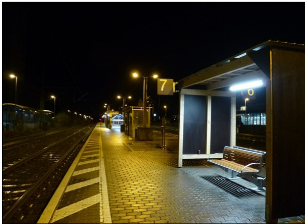
Abbildung 7: Das Bahnsteigdach in Bad Oldesloe wurde zur Erneuerung abgerissen. Einige Bänke sind daher provisorisch überdacht worden.
