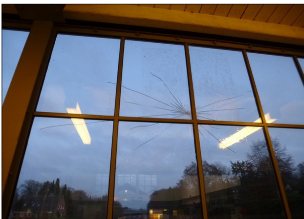
Abbildung 24: Am Zugang vom Empfangsgebäude zur Treppe in Aumühle waren einige Scheiben beschädigt.
