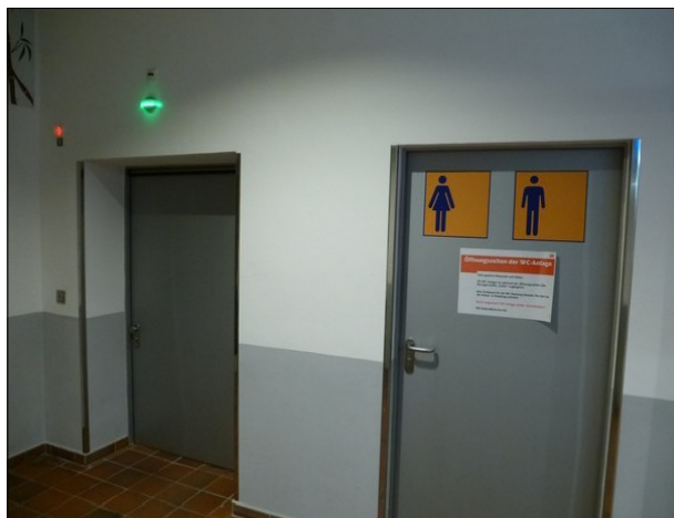
Abbildung 37: Grundsätzlich steht in Itzehoe wieder eine Toilette zur Verfügung. Nur am Erhebungstag war diese wegen einer Verstopfung nicht nutzbar.
