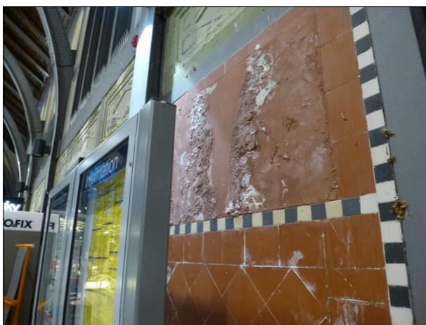
Abbildung 36: An der Wand zwischen den gesperrten Toiletten in Travemünde Strand sind Feuchtigkeitsschäden deutlich erkennbar.
