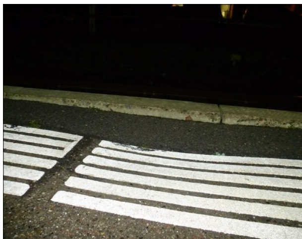
Abbildung 5: Der Bahnsteig in Dagebüll Kirche sackt an einigen Stellen ab, so dass eine Stufe an der Kante entstanden ist.
