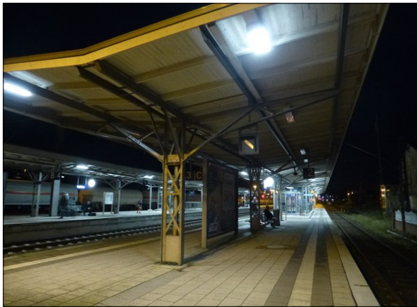
Abbildung 49: An den Bahnsteigdächern in Itzehoe waren in mehreren Bereichen bis zu drei Dachlampen nebeneinander defekt.
