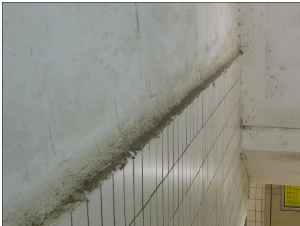
Abbildung 43: In den Treppeneinhausungen an den Bahnsteigen in Husum werden die Vorsprünge an den Wänden nur selten gereinigt.
