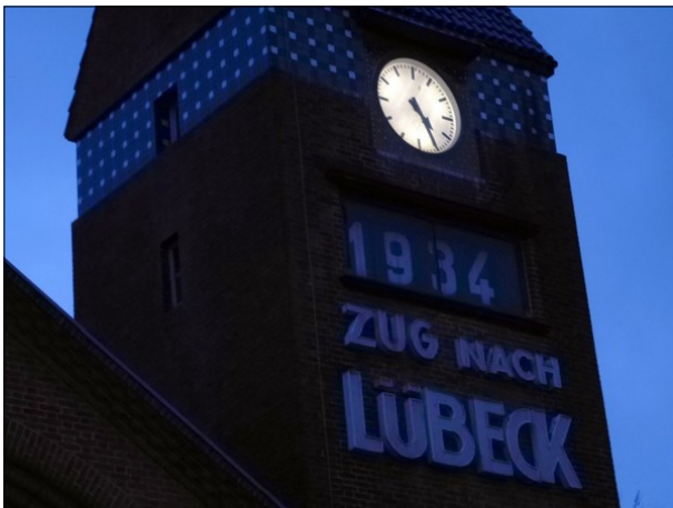
Abbildung 17: Die Anzeige der nächsten Zugabfahrt im Turm des Gebäudes in Travemünde Strand war defekt.
