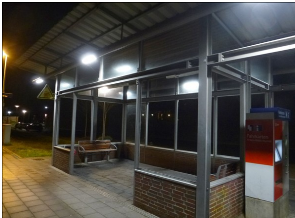
Abbildung 22: Mit neun fehlenden und zwei beschädigten Scheiben trägt der Wartebereich in Lensahn einen großen Teil zur Schadensbilanz an den Stationen bei. Für die Wartehalle ist die Gemeinde zuständig.
