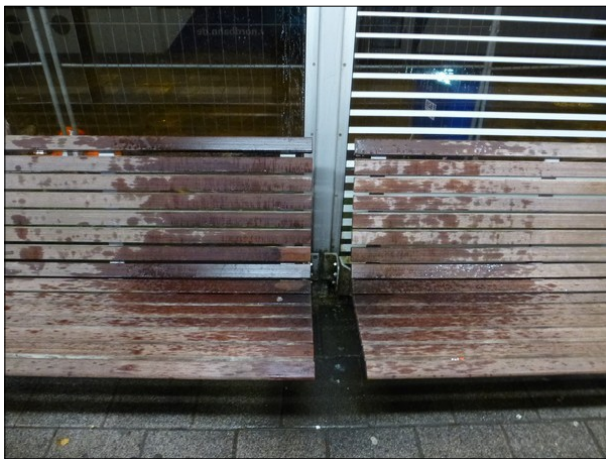
Abbildung 10: Viel Wasser tropft in den Fahrgastunterstand an Gleis 1 in Bad Segeberg. Einige Sitzgelegenheiten waren dadurch nicht nutzbar.
