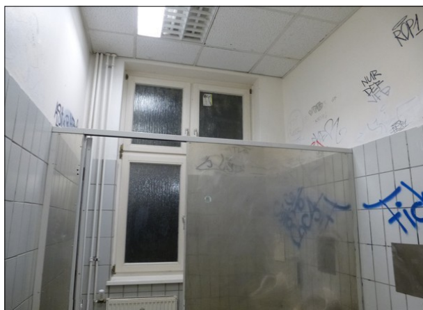
Abbildung 38: Die WC-Anlage in Bad Schwartau war von umfangreichen Schmierereien und einigen Schäden geprägt.
