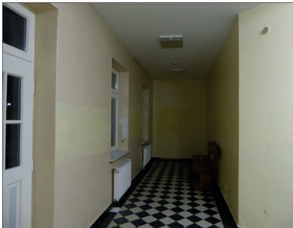
Abbildung 38: Im Warterraum von Hademarschen waren drei Leuchten defekt.
