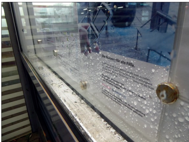
Abbildung 35: An Gleis 1 in Elmshorn waren die Vitrinen in den Unterständen zum wiederholten Mal innen nass.
