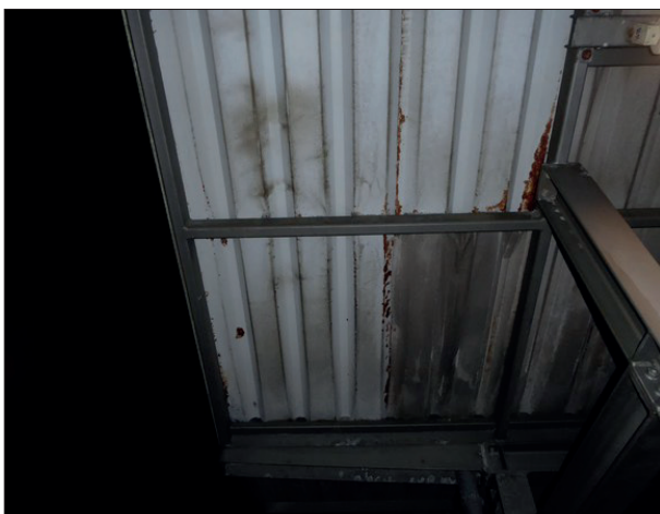
Abbildung 9: Unter der bereichsweise entfernten Tropfschutzfolie der Wartehalle in Morsum ist Rostbildung an der Dacheindeckung zu erkennen.
