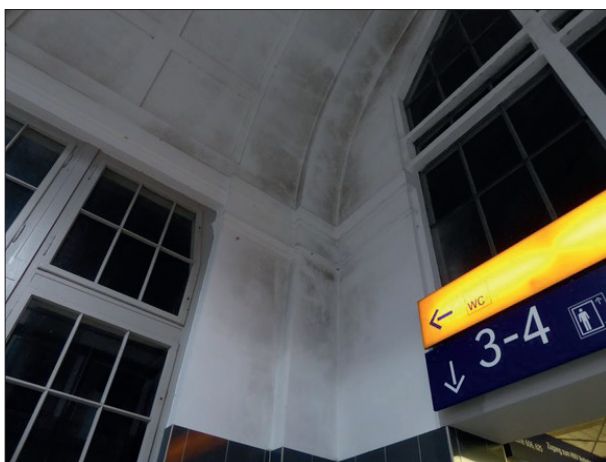
Abbildung 39: In Aumühle sind die Wände und die Decke der Eingangshalle bereichsweise schwarz.
