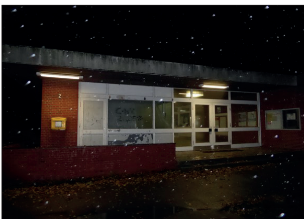
Abbildung 27: Die Graffiti an der Fassade des Bahnhofsgebäudes in Tönning wurden entfernt. Es verblieben die Lackschäden neben dem Eingang und die Kritzeleien an der Westseite.
