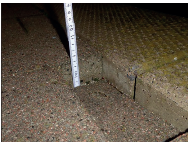
Abbildung 54: Ein Stein war auf dem Bahnsteig der Station dodenhof gut 5 cm abgesackt.
