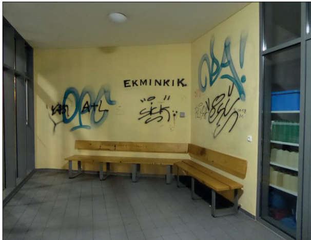
Abbildung 37: Zu den bereits im Sommer verzeichneten Schmierereien im Warterraum von Scharbeutz sind weitere hinzugekommen.
