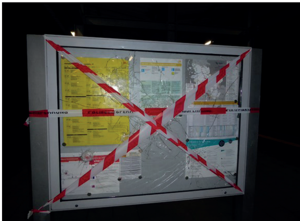
Abbildung 25: Diese stark beschädigte Vitrinenscheibe in Lensahn musste abgeklebt werden. Dadurch war auch der Fahrplan nicht mehr vollständig lesbar.
