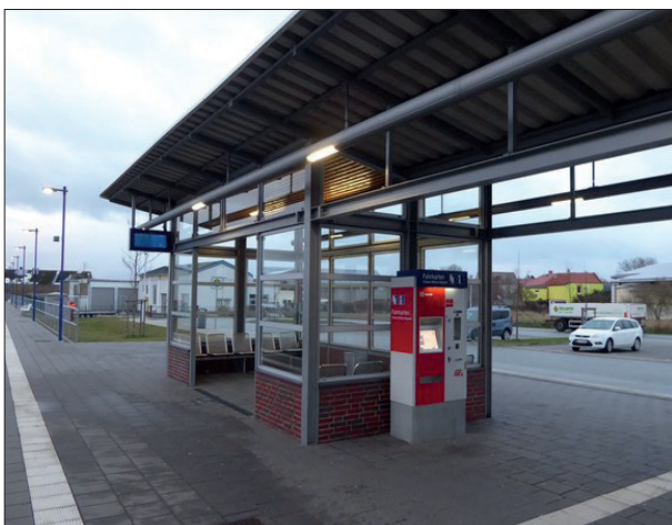
Abbildung 12: Auch mehr als acht Jahre nach Inbetriebnahme ist die Wartehalle in Fehmarn-Burg in einem guten Zustand. Allerdings ist auch hier bereichsweise Algenbildung an der Dachunterseite zu beobachten.
