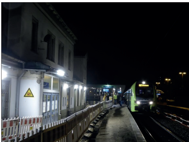
Abbildung 1: Seit Oktober 2018 ist der Bahnhof Pinneberg eine Großbaustelle. Neben der Erneuerung der Regionalbahnsteige wird eine neue Unterführung gebaut. Durch diese werden die Bahnsteige barrierefrei erreichbar sein.
