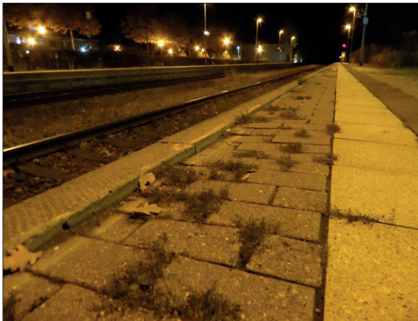
Abbildung 4: Am Bahnsteig für Gleis 2 in Preetz gibt es bereichsweise Absackungen mit Stufenbildung von 2-3 cm Höhe vor der Bahnsteigkante.
