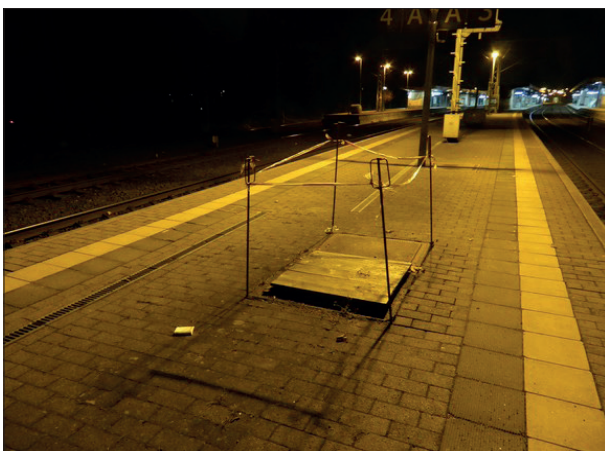
Abbildung 6: Seit dem Herbst 2017 ist in Neumünster ein Bereich des Bahnsteigs der Gleise 3/4 abgesperrt, da ein Schachtdeckel stark beschädigt ist.
