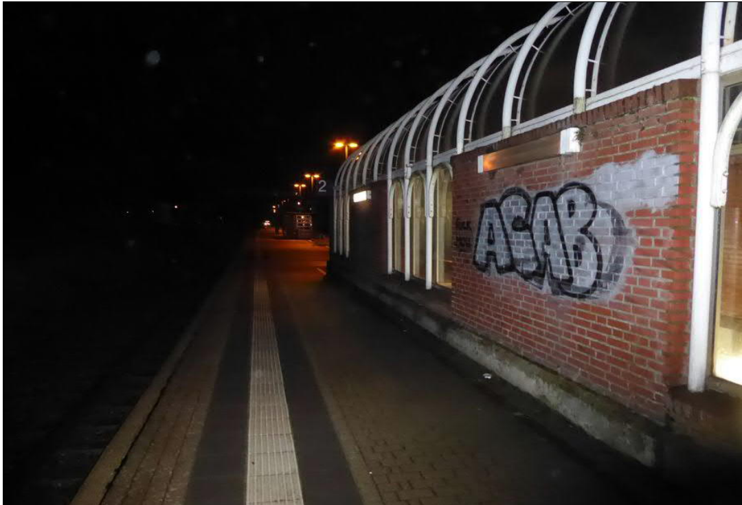
Bredstedt: Bahnhof an der Strecke Hamburg - Westerland. Die Treppeneinhausungen waren ebenso beschmiert wie die Aufzugseinhausungen und die Fußgängerbrücke.
