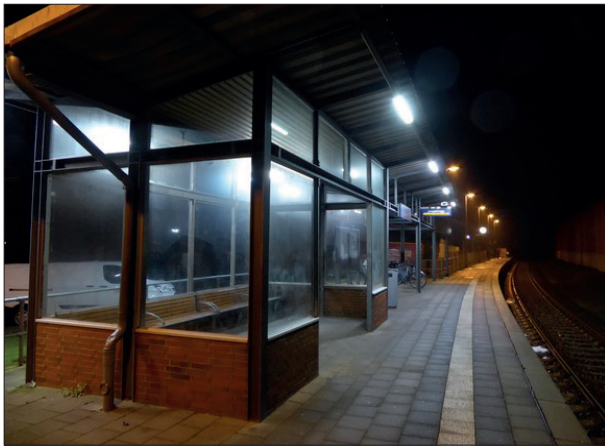
Abbildung 7: In Wesselburen wurden im Spätsommer die fünf fehlenden Scheiben der Wartehalle erneuert. Erfreulicherweise gibt es bisher keine neuen Schäden.
