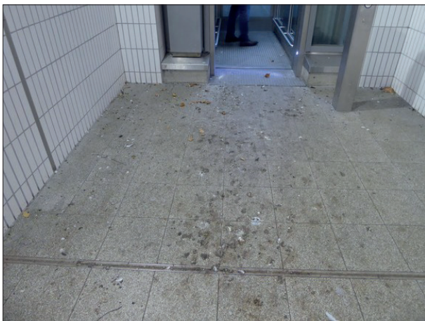
Abbildung 47: Vor den Aufzugseingängen im Tunnel von Itzehoe waren die Verschmutzungen durch Taubenkot besonders umfangreich.
