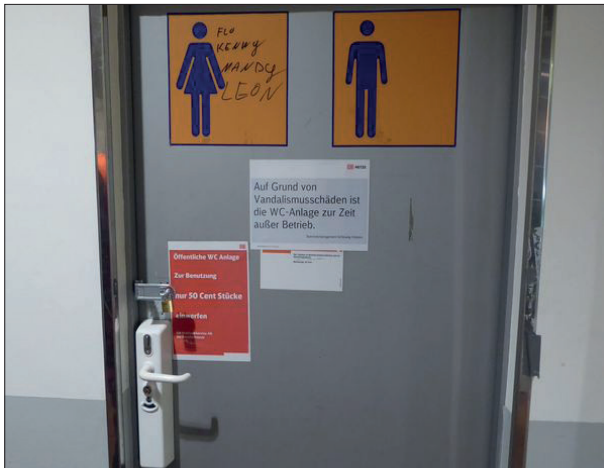
Abbildung 40: Die WC-Anlage im Bahnhof Itzehoe war aufgrund von Vandalismusschäden gesperrt.
