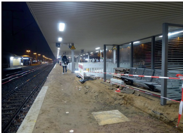
Abbildung 53: Durch die Bauarbeiten kam es in Pinneberg zu Einschränkungen des Wartekomforts an den Gleisen 2-5. Aufgrund der Bauarbeiten wurde der Bahnhof Pinneberg im Bereich Wartekomfort allerdings nicht bewertet.
