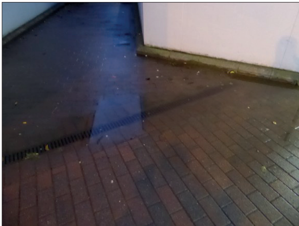
Abbildung 46: In Keitum war die Entwässerungsrinne am Fuß der Treppe zu Gleis 2 verstopft. Es kam zur Bildung einer großen Pfütze.
