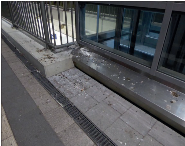
Abbildung 5: Im Bahnhof Itzehoe ist bei den Verschmutzungen durch Taubenkot eine zunehmende Tendenz zu verzeichnen.
