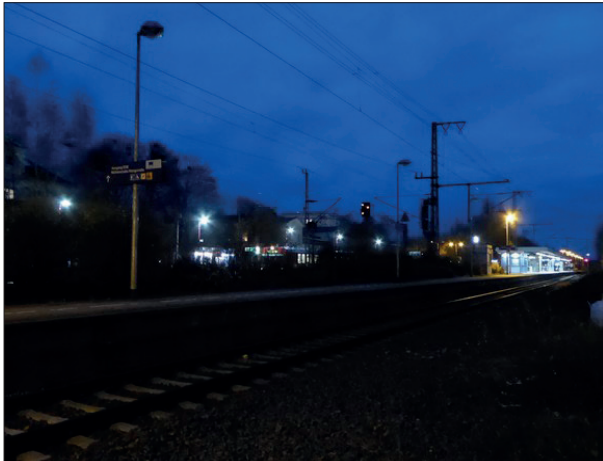
Abbildung 49: In Elmshorn waren an Gleis 3 drei Lichtmasten hintereinander defekt.
