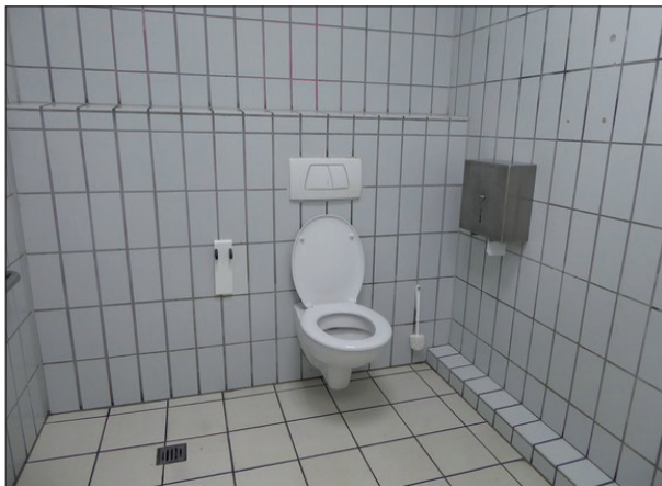
Abbildung 41: Die Toiletten im Bahnhof Timmendorfer Strand gehören meist zu den saubersten im Land. Allerdings fehlen seit rund zwei Jahren die Haltebügel für Behinderte. In diesem Winter war zudem das Herren-WC verraucht.
